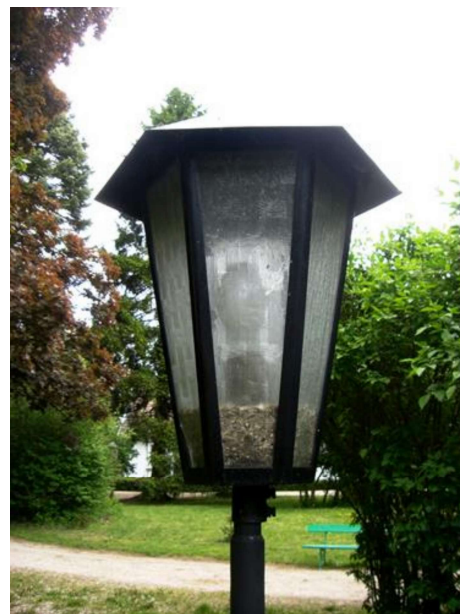
Abb. 2 Insektentod an Leuchtkörpern: Der untere Leuchtenteil ist mit Insekten gefüllt, die hier zu Tode kamen. Durch Wahl einer entsprechenden Schutzklasse (IP 65) kann dies vermieden werden. Foto: Conrad Fink
